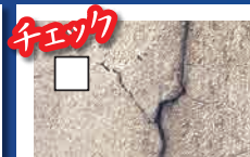
ひび割れ・クラック
