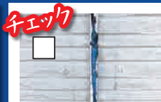
シーリング・コーキングのひび割れ・縮み・はがれ
