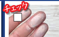
外壁の表面に触ると白い粉がつく
